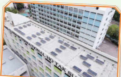
學校天台共安裝了27塊高效的太陽能板，組成LHTS的圖樣
